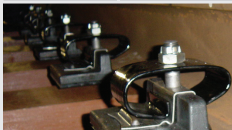
レール締結装置
